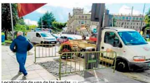
Localización de una de las averías. EP
